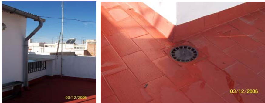
Resim 23. atıda yađmur suyu tesisatı (Picture 23. Plumbing of rain water on the terrace)
