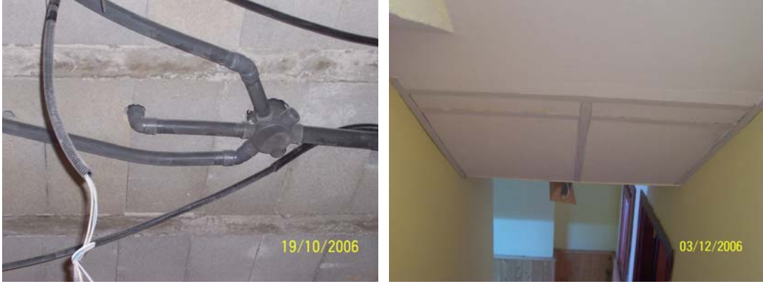
Resim 19. haberleşme tesisatı ve asma tavan uygulaması (Picture 19. Communication line and application of suspended ceiling)
