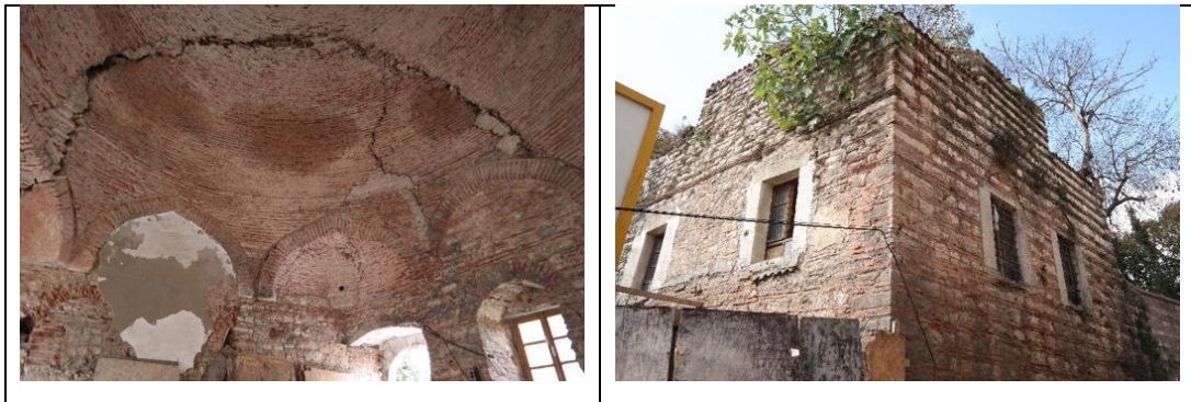
Şekil 1. Mescid yapısındaki hasarlar (Mehmet Selim Ökten, 2014)
