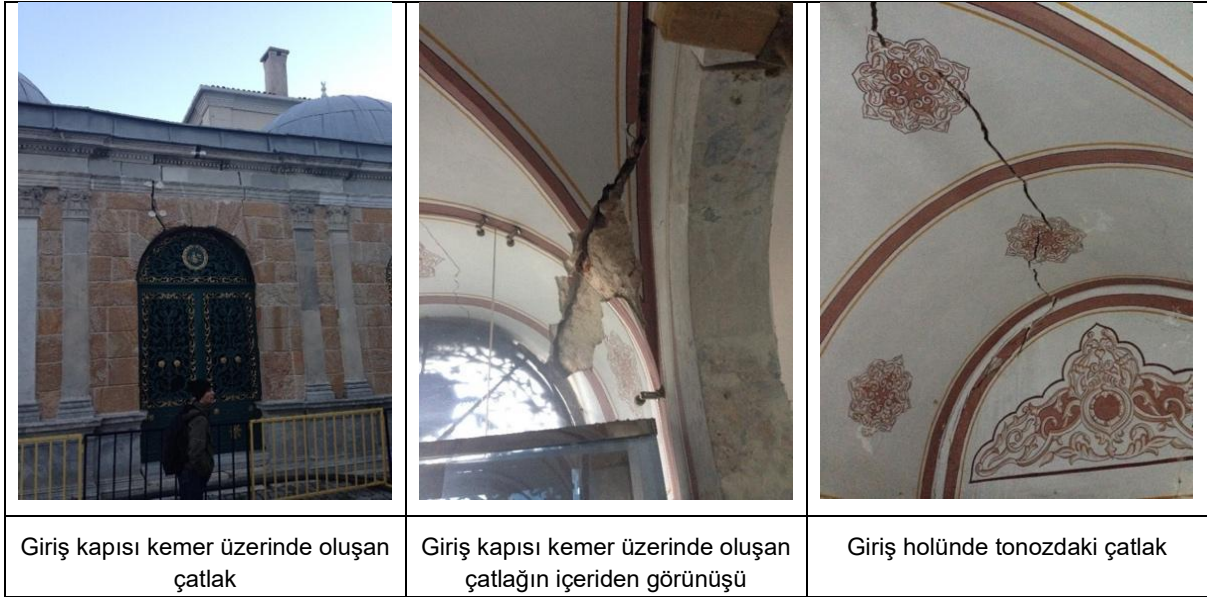
Şekil 6. Türbede oluşan hasarlar (Mehmet Selim Ökten, 2014)
