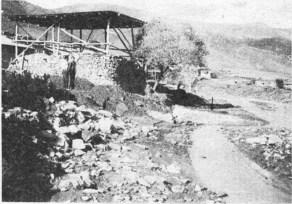
Foto, 4: Sel suları ile yerinden sökülerek sürüklenen istinat duvarları. Rizekent köyü, doğuya bakış.
