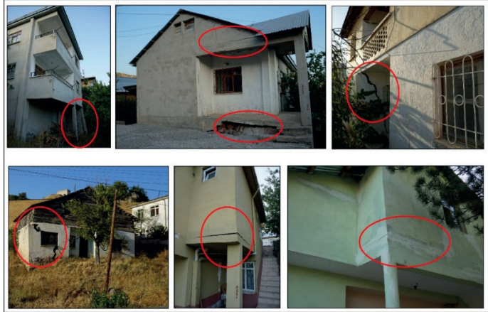
Şekil 5: Çalışma alanında tespit edilen yapısal hasar. Figure 5: Structural damage was detected in the study area.
