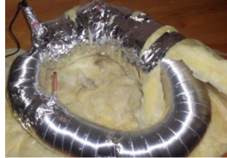
Şekil 3: Yalıtım malzemesi ile kaplanmış alüminyum flex.
