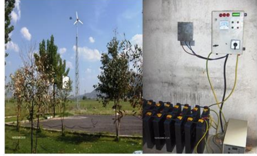
Şekil 3. Kurulu rüzgar türbini ve kontrol ünitesi.
