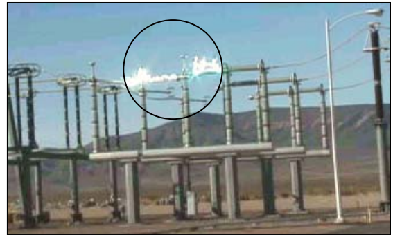
Şekil 5. Bir yük tevzi merkezindeki izolasyon problemi
