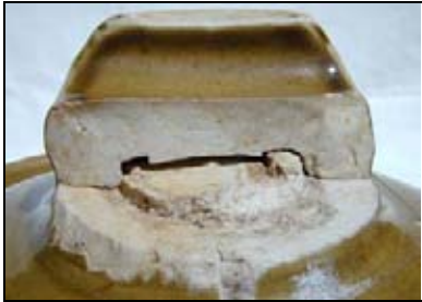
Şekil 7. Üst kısmı hasara uğramış bir porselen izolatör
