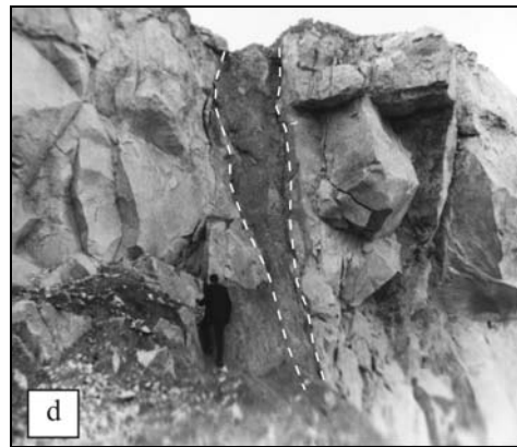
Şekil 3. a, b ve c: Ulumuhsine formasyonu (Tu) ile Konya formasyonu (Qk) arasındaki Yazır fayının Taşkesti T. doğusundaki görünüşü, d: Taşkesti T. kuzeydoğusunda gösel kireçtaşlarında izlenen içi alüviyal çökellerle doldurulmuş bir yarık
