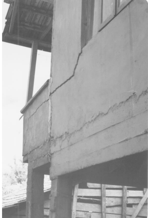
Figure 2. Les batiments endommages en raison d'affaissement minier dans le Bassin Houiller de Zonguldak
