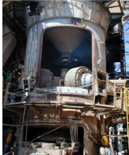
Şekil 2. Merdanenin uzaktan çalışma görüntüsü (View of the working roller press)
