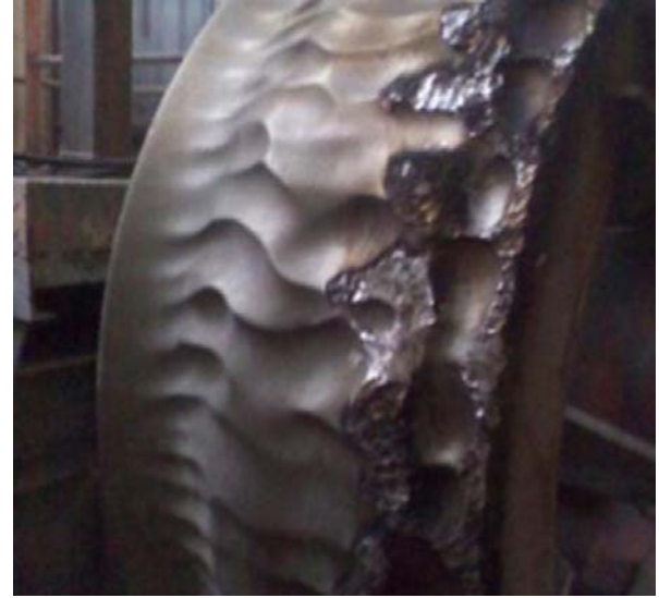
Şekil 9. Aşınmış vals yüzeyi (Worn roller mill surface)
