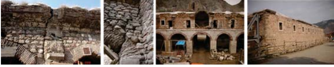
Şekil 6: Deveci Han Restorasyon Öncesi Harap Durumu (Tokat Vakıflar Bölge Müdürlüğü Arşivi)
