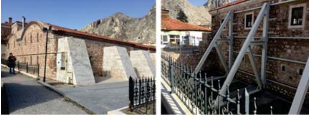
Şekil 7: Duvarlara Yapılan Taş ve Çelik Payandalar (Akın Arşivi, 2019)
