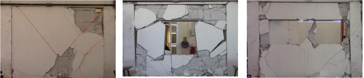
Şekil 12. Deney sonunda meydana gelen hasarlar ve dolgu duvarlara ait kırılma biçimleri.
