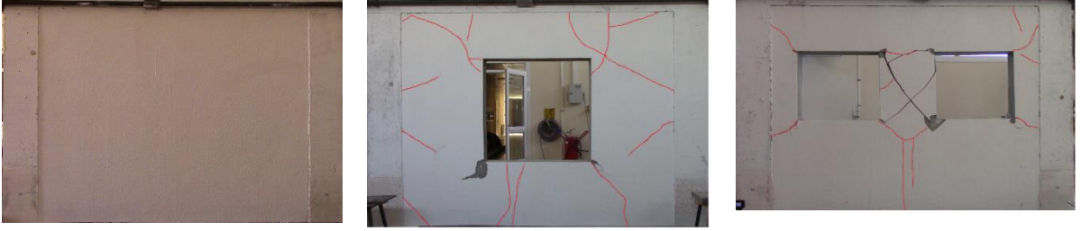
Şekil 10. %1 ötelenme oranında, dolgu duvarlarda meydana gelen hasarlar.
