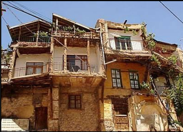
Fotoğraf 7. Sille’de tahrip olmuş konut. Photo 7. Destroyed residence in Sille.
