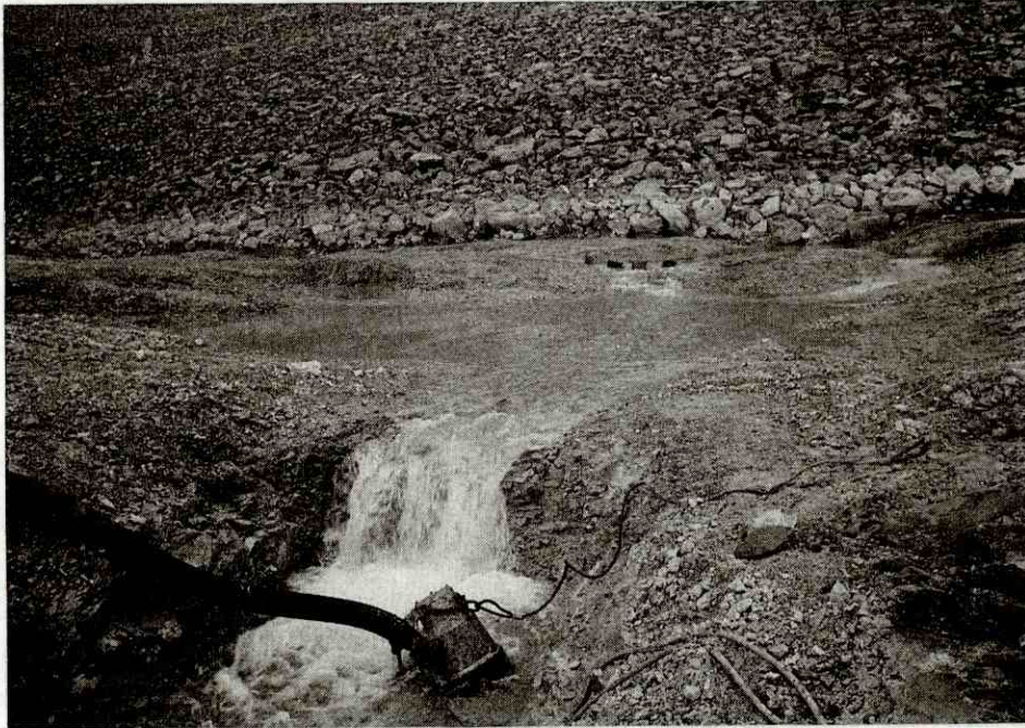
Fotoğraf 2: Topuk kaynaklarının toplandığı pompaj çukuru. Photo 2: Pumping station collecting the water from the toe of dam.
