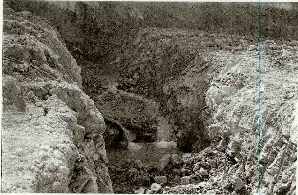
Fotograf 4: Dolu savak şüt kanalı, kazısı sırasında ortaya çıkan kaynaklar. Photo 4: The resources found while constructing the spillway channel.
