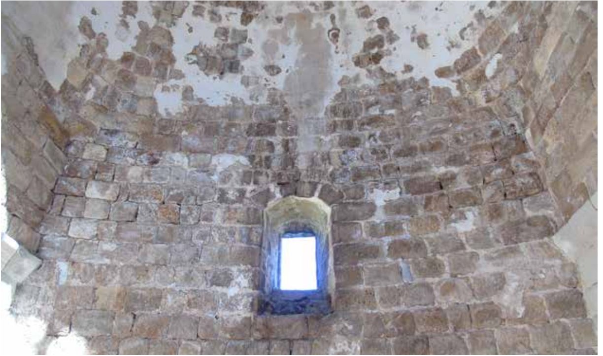
Şekil 11: Horan Bölümü Sıva Kalıntıları, 2019
