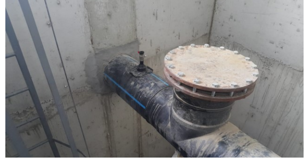
Şekil 4. Enerji Tesisi Giriş Ana Hattı
