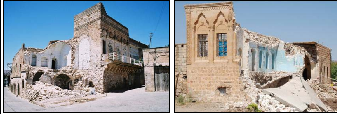
a, b. Bakımsızlıktan dolayı bir bölümü yıkılan evler
