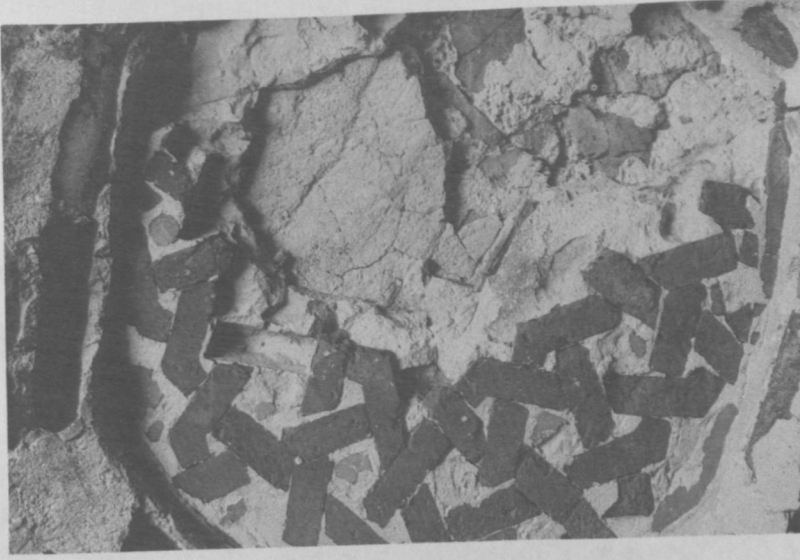
Res. 6: Aksaray- Melik Mahmud Gazi Hangâhı, giriş eyvanı üzerindeki, ana eyvandan girişteki 2. pano'nun görünüşü, 1991.
