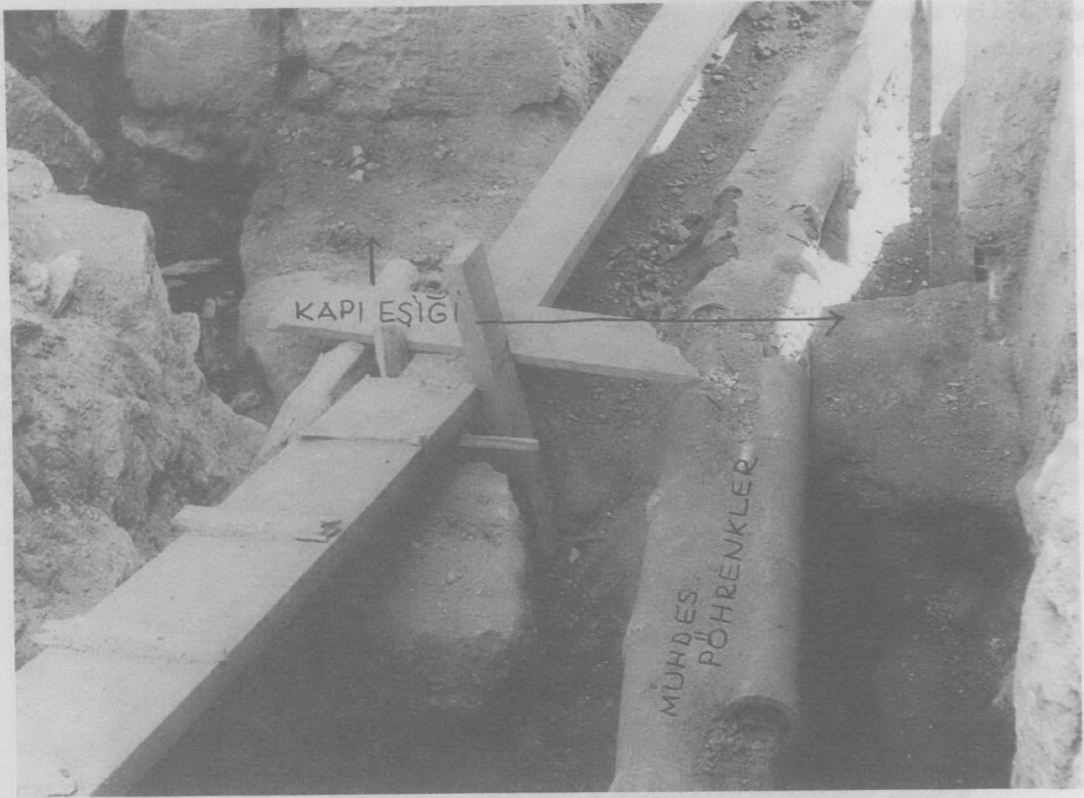
Res. 6: Islak alan kapı eşiği üstündeki muhdes pöhrenkler ve solda üst kat merdiven kapı eşiği.
