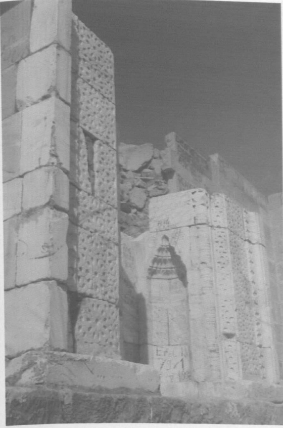
Res.27: Hıdırellez Köşkü portalı (onarım yarım bırakılmış).
