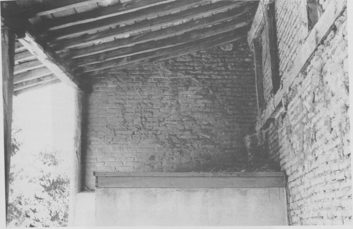
Fot. 24- Son cemaat tonoz kemerinin bakiyesi ve kemerin minare kaidesindeki sıva izi (1965).
