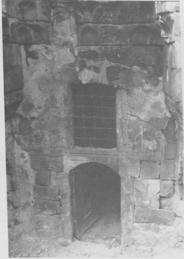
Fot. 50- Kayseri- Hoca Hasan İmaretinin giriş kapısı. Yiğma söveli kapının orta kısmı sonradan doldurularak küçük bir kapı yapılmış ve üst kısmına bir pencere açılmıştır. Bu ameliye sırasında orijinal kapı kemeği de kesilerek pencere taahfif kemerinin altına getirilmiştir (1976).
