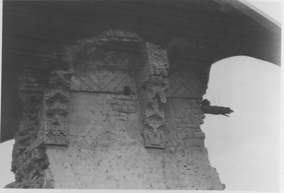
Fot. 18- Konya, Kılıç Arslan Köşkü. Tuğladan inşa edilmiş mukarnaslı konsollar ve tonoz kalıntısı (1963).
