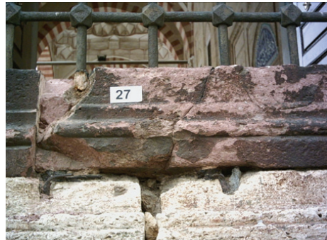
Şekil 15. Edirne Selimiye Camii Güney Cephesi/demir pas lekeleri, kayada büyük parça kaybı ve kimyasal çözünme tahribatı görülmektedir. Yapıtacı; beyaz bej renkli, iri-orta taneli, düşük orta derecede çözünmüş, mangan içerikli yüksek kuvars içeren kireçtaşları (dolomit%2, feldispat%0, kalsit%80, kuvars %14) (Dal, 2005).
