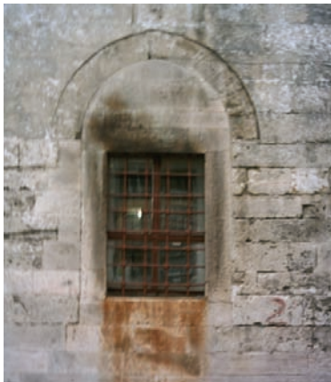
Şekil 14. Kırklareli Hızırbey Hamam'ında görülen metallerin korozyona uğraması ile yapı cephesinde görülen pas ve is lekelerinin oluşturduğu tahribat
