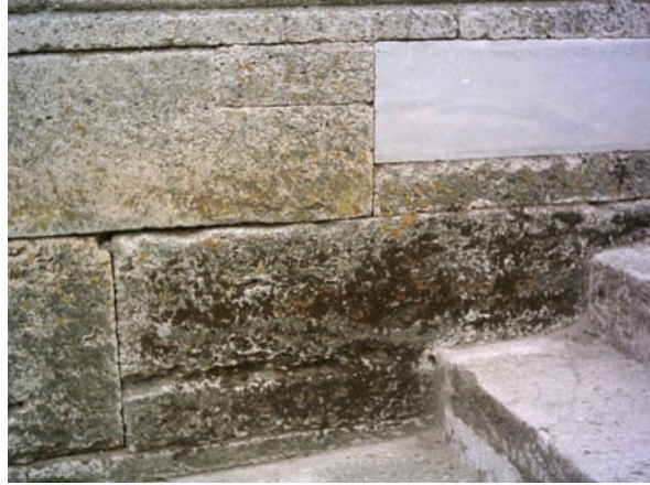
Şekil 19. Edirne Selimiye Camii Kuzey Cephe tretuar üstü ve merdiven girişi cephesinde yosunlaşma ve bakteri şeklinde oluşan tahribat.
