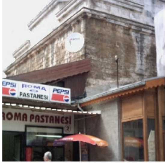
Şekil 17. Kırklareli Hızırbey Külliyesi Arastası'nın cephelerine dayanarak inşa edilen yeni yapılaşmaların oluşturduğu tahribatlar.
