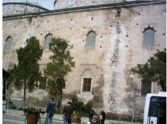
Şekil 9. Edirne Eski Cami güney cephesinde asitli yağmur sularının ve tapraktaki tuzların kapilarite ile cephede yarattığı tahribat (Dal, 2005).
