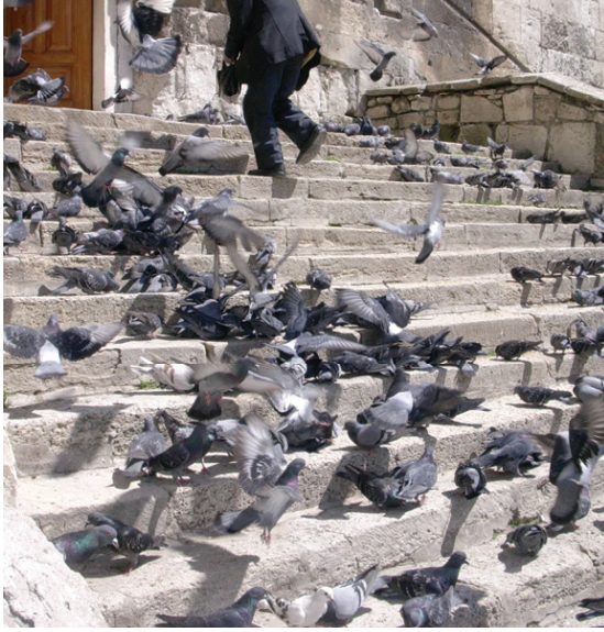
Şekil 16. Edirne Üç Şerefeli Cami'inde güvercinlerin yemlenirken merdiven taşlarında oluşturdukları tahribatlar.
