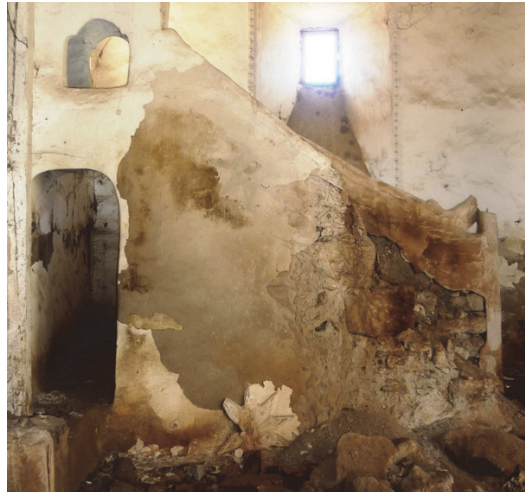
Fot. 24. Değirmenyolu/Parlasan Köyü Hacı Ahmet Camii yıkılmış minber kalıntısı.
