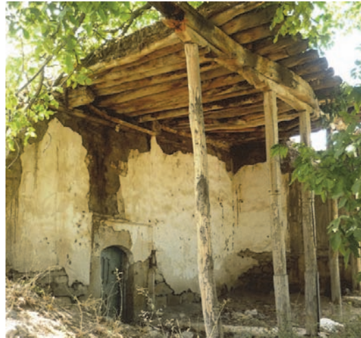
Fot. 11. Değirmenyolu/Parlasan Köyü Hacı Ahmet Camii'nin yarı yıkılmış kuzey cephesi.
