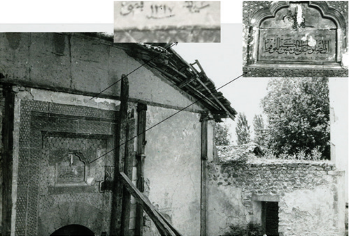
Resim 7. Taçkapının onarımdan önceki durumu (Gültekin 1968: R.26)
