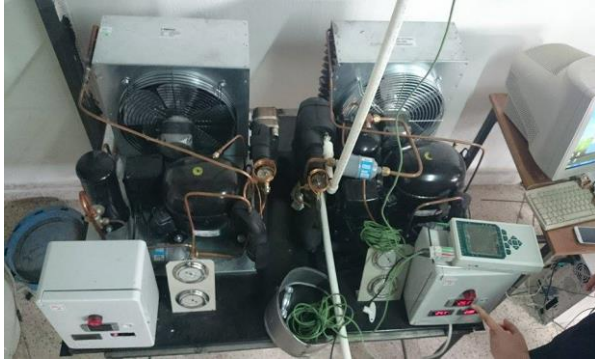
Şekil 4. Plakalı ısı eşanjöründen oluşan soğutma sistemi
