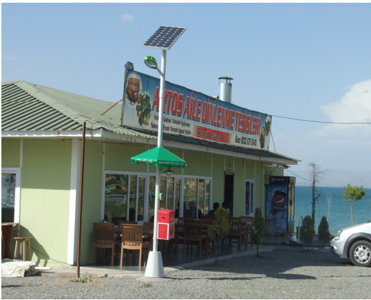
Şekil 8: Van ili, Edremit ilçesinde aydınlatma amaçlı güneş enerjisi uygulaması
