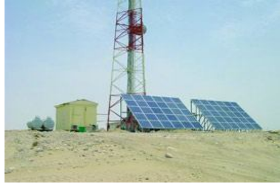
Şekil 9: Baz istasyonunun elektrik enerjisi ihtiyacının güneş enerjisiyle sağlanmasına örnek
