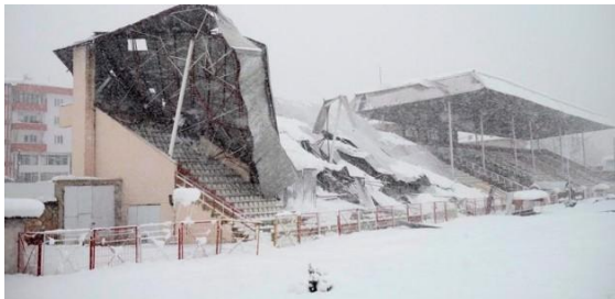
Şekil 3. Kar yükünden dolayı çökmüş stadyum çatısı
