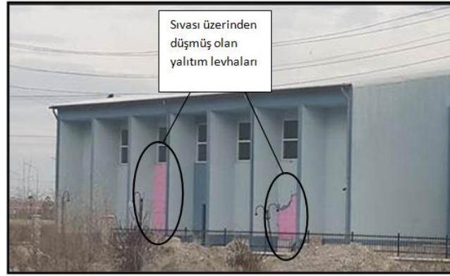
Şekil 3. Yalıtım levhası üzerinden sıvası düşmüş bir yapı
