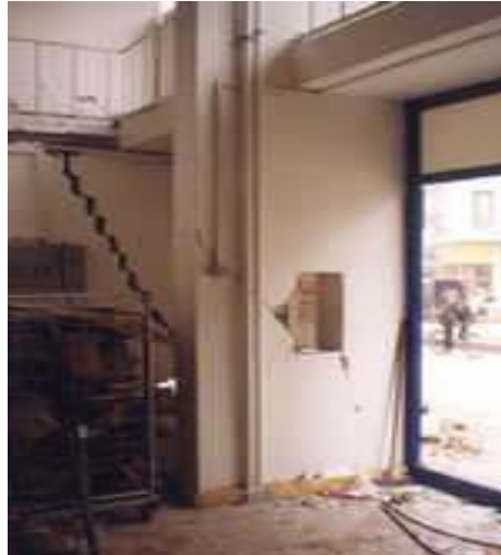
Şekil 26. Betonarme Detay Hatası
