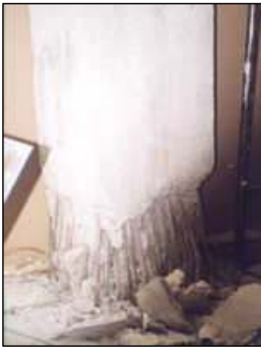
Őekil 16. Kolon Alt Bölgesi Etriye Sıklařtırması Yok
