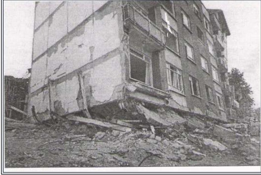
Őekil 15. Yumuřak Kat Davranıřı Gösteren Zemin Katın Çökmesi
