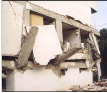
Şekil 13. Yapıda Deprem Perdesi Bulunmaması (17.08.1999 Gölçük)
