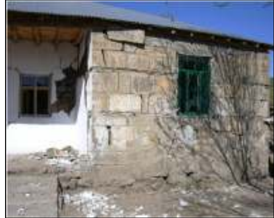
Şekil 11. Hafif Ot Örtülü ve İnce Saç Teneke Kaplı Çatılı Yıęma Bina
