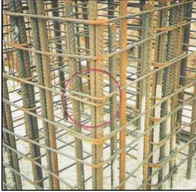
Şekil 31. Yanlış Etriye Köşe Kanca Yapımı
