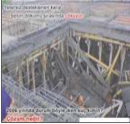
Őekil 22. Döőeme betonunun çökmesi
