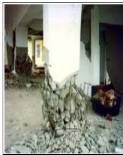
Őekil 17. Kolon Alt Bölgesi 1 Metrelik Kısımda 2 Etriye Görünmektedir
