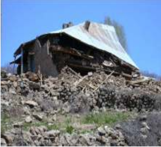
Şekil 4. Zayıf ve Gevşek Köşe Bağlantılı Bina
