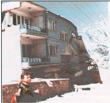
řekil 2. Tařıyıcı Duvarlardaki Kapı ve Pencere Bořluklarının Fazla Olması
