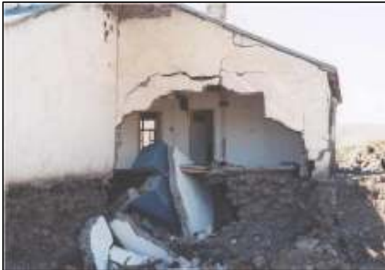
Şekil 6. 1 Mayıs 2003 Bingöl Depremi Gevşek Zeminli ve Duvar Altı Hatılsız Bina [4].
