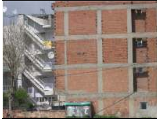
Şekil 19. Deprem Etkisine Dayanmayan Mimari Tasarım ve Zayıf Taşıyıcı Sistem
