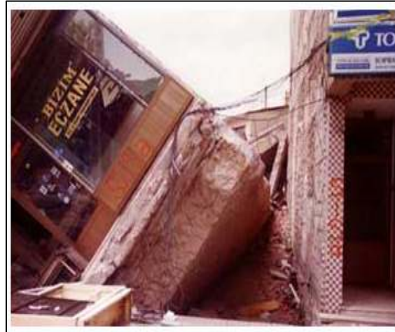
Őekil 24. Yapım hatası olarak yetersiz temel derinlięi
