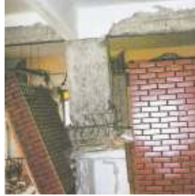
Şekil 32. Yanlış Etriye Bağlantılı Bir Kolonun Marmara Depremi Sonrası Hali
