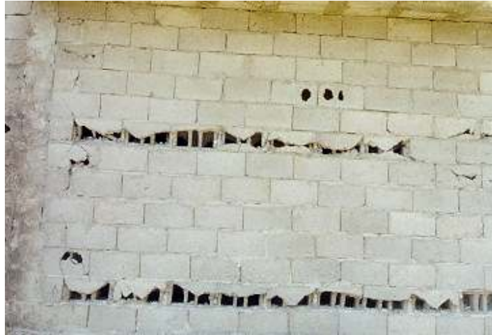
Şekil 28. Briket Dolgu Duvarda Kesme Kırılması (22 Haziran 1998 Adana Ceyhan Depremi)
