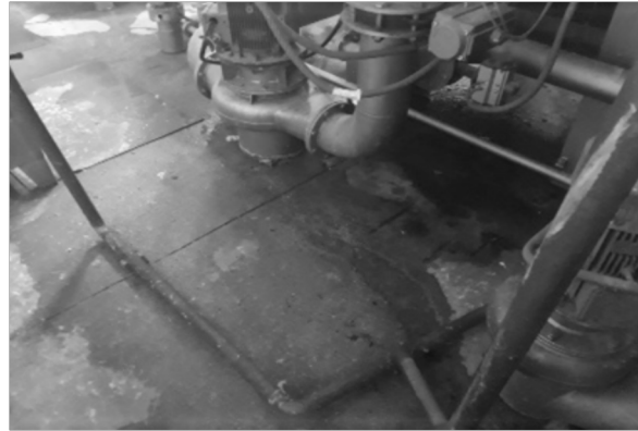
Şekil 5: Kondens Dönüş Hataları
