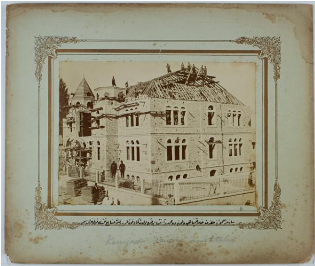
Resim 12. İnşaat halindeki Konya Sanayi-i Nefise Mektebi. Fotoğraf: Garabet K. Solakian. İstanbul Üniversitesi Nadir Eserler Kütüphanesi II. Abdülhamid Han Fotoğraf Albümleri (yer no. NEKYA779-92/4).
