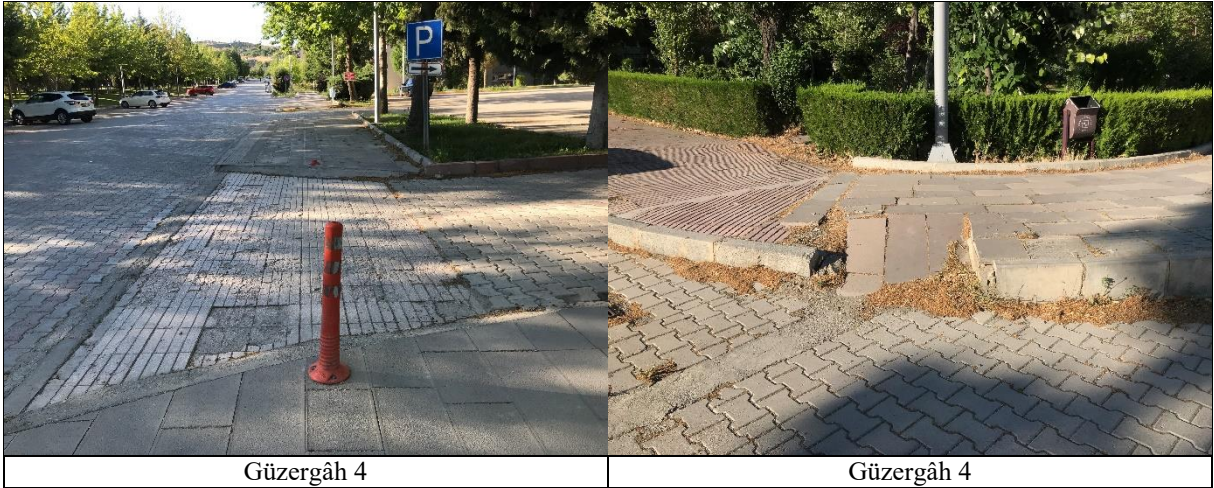
Şekil 11. Yerleşke ulaşım ağında döşeme bozulmaları.
