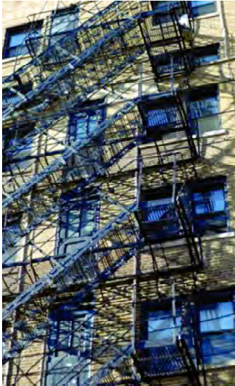
Resim: 3 Birçok ülkede yangın merdivenleri yapının algısını iyi ya da kötü yönde değiştirmektedir.
