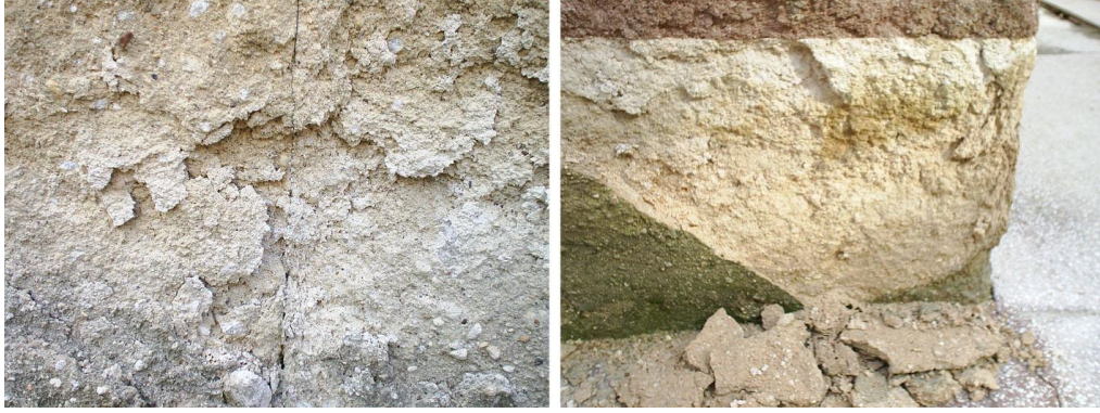
Şekil 3. Caminin duvarlarındaki beyaz ve pembe renkli kireçtaşı bloklarının yüzeylerinde meydana gelen kabuklanma, kopma ve dökülmeler.
