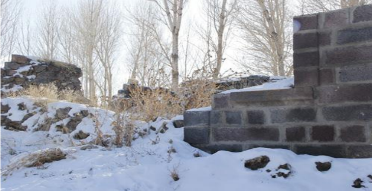
Foto. 10: Giriş kapısı ve iki yanındaki pencerelerin deprem sonrası görüntüsü (E. Bingöl).
