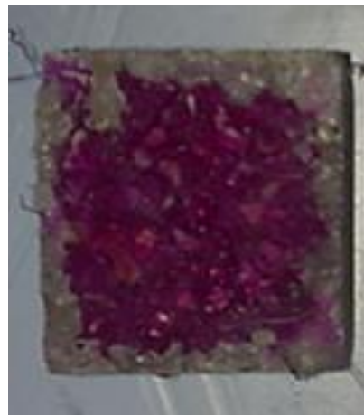
Şekil 15. Betonda karbonatlaşma etkisi (The effect of carbonation in concrete)
