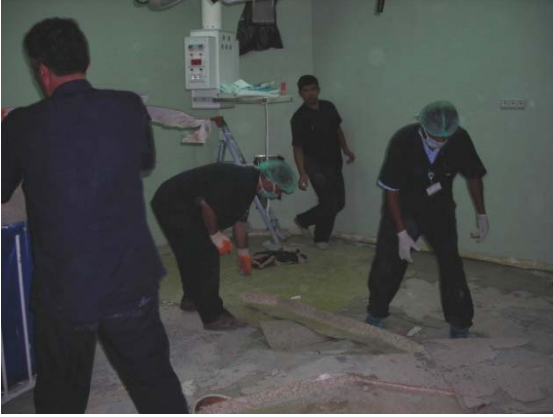
Şekil 14. Bir döşeme kaplaması altlığının yanlış uygulaması
