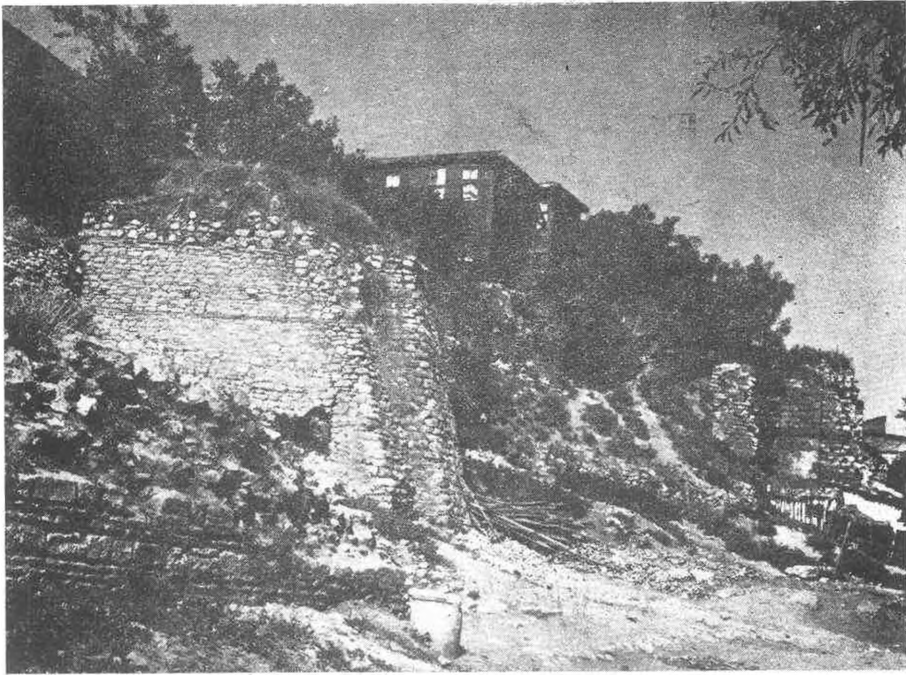
Res. 4 — Ayazına gerisindeki B-C istinat duvarı.
