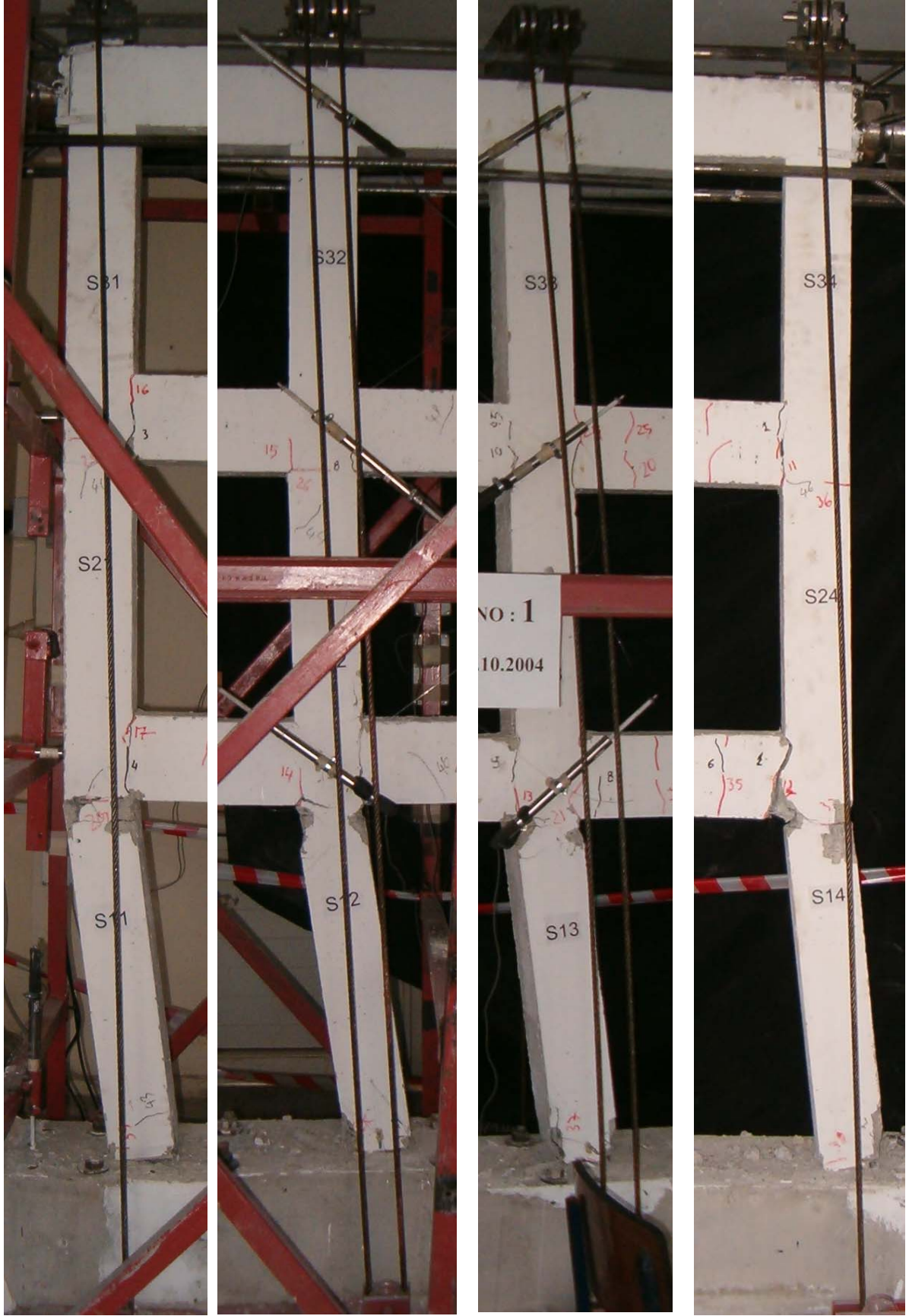
Şekil 28. T1 numunesinde mesnetlerde ve zemin kat kolon uçlarında oluşan mafsallar.
