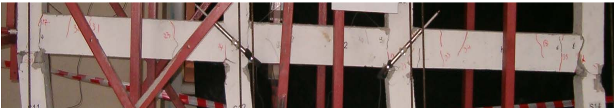
Şekil 31. T1 deney numunesi 1. kat kirişlerinde hasar oluşumu.
