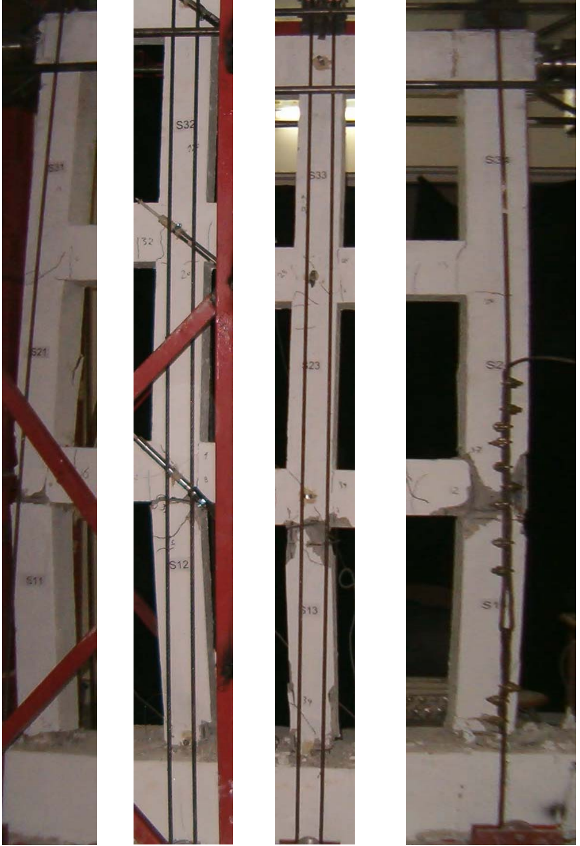
Şekil 36. T2 deney numunesi mesnetlerinde ve zemin kat kolonlarında oluşan mafsallar.
