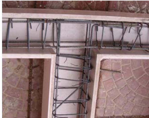
Şekil 14. T2 numunesinin etriyesiz kolon kiriş birleşim bölgesi. Figure 14. Beam column connections without stirrups for Specimen T2.
