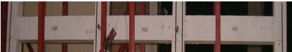
Şekil 38. T2 deney numunesi 2. kat kirişlerinde hasar oluşumu.
