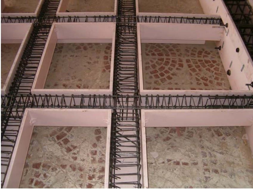
Şekil 13. Kolon-kiriş birleşim bölgesinde devam eden etriyeler ve sıklaştırma bölgesi. Figure 13. Decreased stirrup spacing region and continued stirrups in beam column connection.
