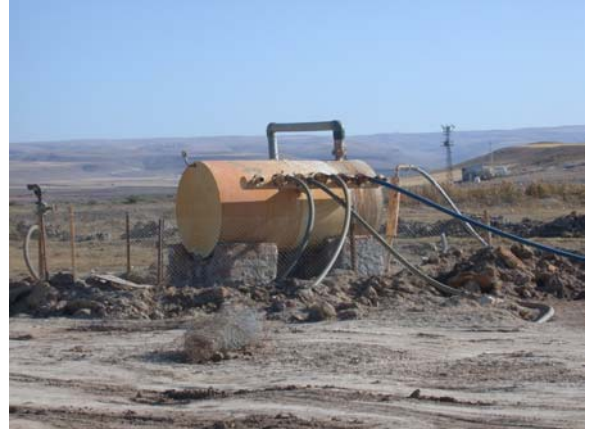
Resim 5. Kuyular arası toplama tankı. Photo 5. Collection tank between wells.
