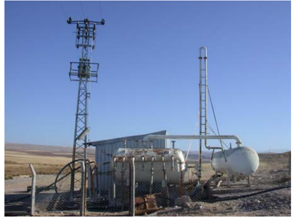
Resim 6. Bölgesel CO 2 toplama tankı. Photo 6. Regional CO 2 collection tank.
