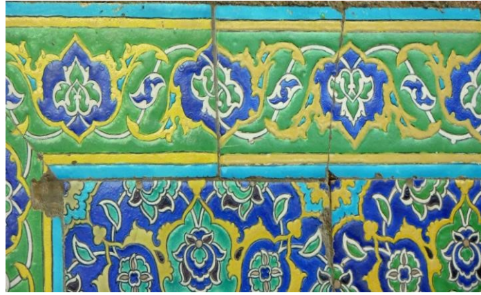
Fotoğraf 7: Bozüyük Kasım Paşa Camii kuzey cephe taçkapının solundaki pencere alınlığı bordür detay
