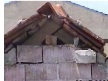
Şekil 11. Onuncu yüklemede oluşan hasar. Figure 11. Occurred damages for 10 th loading.
