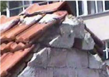
Şekil 9. Dokuzuncu yükleme sonunda sıvasız kalkan duvarın görünümü. Figure 9. The view of without plaster gable wall at the end of the 9 th loading.
