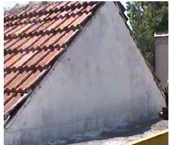
Şekil 1. Sıvalı kalkan duvarda oluşan kılcal çatlaklar.
