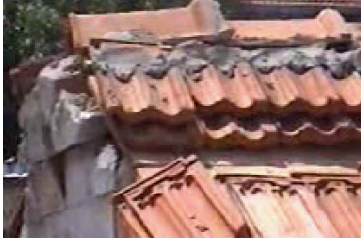
Şekil 8. Sıvasız kalkan duvarın görünümü. Figure 8. The view of without plaster gable wall.
