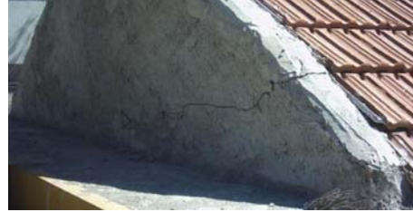
Şekil 15. İkinci yüklemeye oluşan sıva çatlakları.
