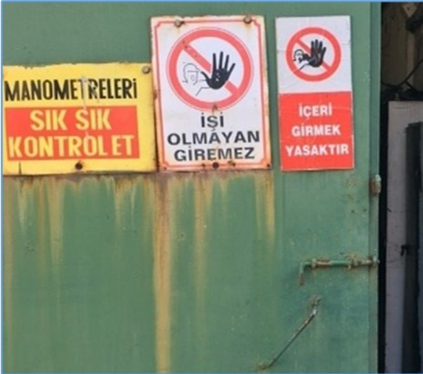
Şekil 19: Kompresör dairesi uyarı levhaları
