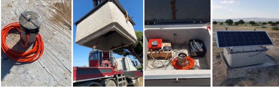
Şekil 9. Kuyu başı ve sensör kablosu (üst sol); kuyu başına beton kabinin yerleştirilmesi (üst sağ); kabin içi ekipman (alt sol); istasyona elektrik sağlayan güneş paneli (alt sağ) (Wellhead and sensor cable (above-left), installation the cabin at the well head (above-right), equipments in the cabin (below-left), solar panel for the station which is provided power ( below-right) )
