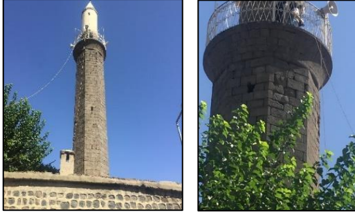
Şekil 8.Hoca Ahmet Cami minaresinde harç kaybı ve ayrılmaya bağlı oluşan yapısal sorunlar
