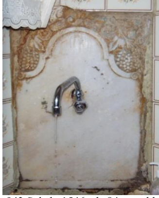
Res.4- Pazaryeri Mahallesi, 943 Sokak, 1546 ada 84 parseldeki konutun mutfak çeşmesi.
