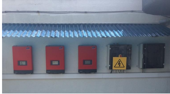
Şekil 4. DUBİT çatısındaki fotovoltaik paneller için kullanılan 3 invertör ve kontrol cihazı.
