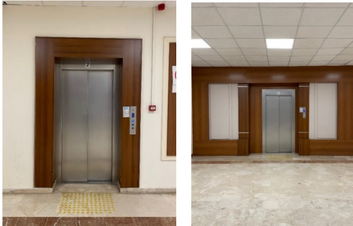
Kütüphane binası asansörleri
