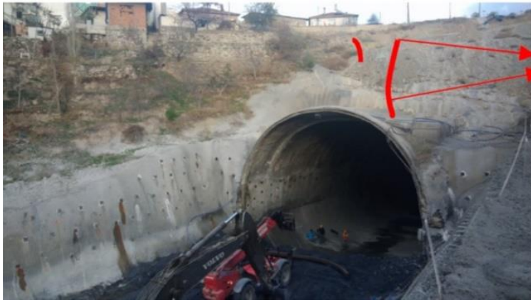
Şekil 8. Giriş portal şevi genel görünümü ve oluşan çatlaklar
