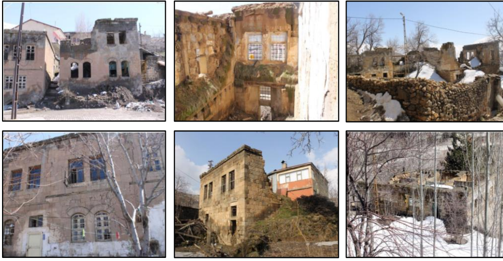
Şekil 17. Bitlis kent merkezindeki kültür varlıklarında insan kaynaklı bozulmalar ( https://www.facebook.com/kudeb.bitlis/photos ).
