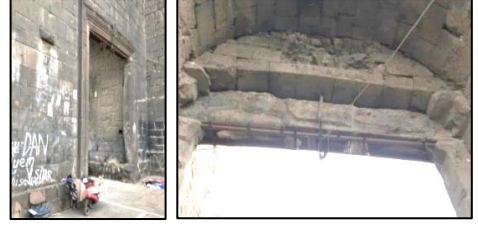
Şekil 8. Güney Kapıdaki (K3) malzeme kaybı hasarları
